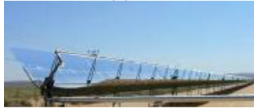
Параболічна сонячна електростанція в Каліфорнії
